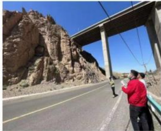
葛家沟沟口崩塌
