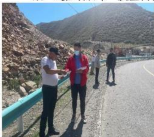
石仁子沟水库西侧公路崩塌
