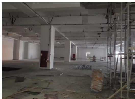
图五 事故现场周边作业环境
