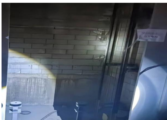
图四 事故发生电梯井
